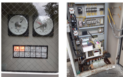
消雪装置制御盤
