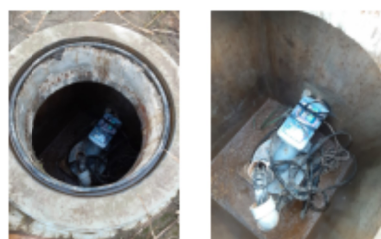
マンホール内水位計、流量計と LoRa送信器
